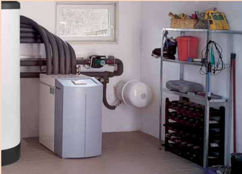
Eine Sole/Wasser-Wärmepumpe kann dank bester Schalldämmung auch im Hauswirtschaftsraum aufgestellt werden.
